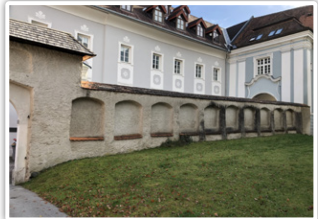
An der östlichen Mauer des Kirchhofs sind noch die leeren Grabnischen erhalten.
