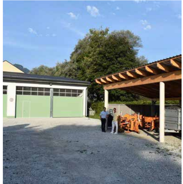
GF Fölsner und Bgm. Gangl beim Lokalaugenschein der Umbauarbeiten am Bauhof und Besprechung der weiteren Sanierungsmaßnahmen
